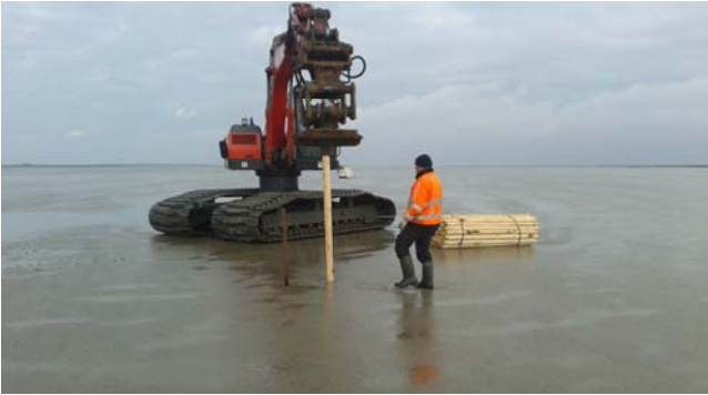
Het heien van lange palen van 1.80 meter in de wadbodem. De palen staan om de halve meter en gaan ver meter de wadbodem in om de constructie golfslag- stormproof te maken.
